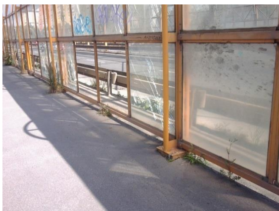
Obr. 4-2 Vymlácené či narušené tabule
